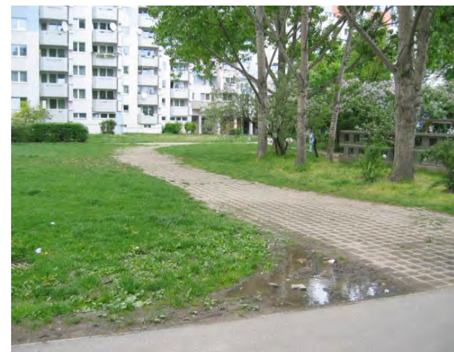
1210 Wien, Mitterhofergasse 2-18, Dr. Franz Koch-Hof: Bei dem nachträglich geschaffenen Weg wurde auf den entsprechenden Unterbau verzichtet - das Wasser rinnt nicht ab. Defizite in der Freiraumgestaltung sind festzustellen.
