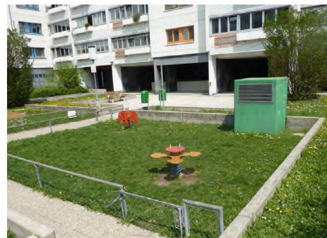
Kleinkinderspielplätze sind oft sehr düftig ausgestattet und schlecht positioniert. Hier fehlt u.a. der Sonnenschutz, die Einfriedung ist mangelhaft und der Lüftungsschacht der Tiefgarage ist nicht gut angeordnet. 2., Engerthstr. 148-150 Robert Uhlir-Hof
