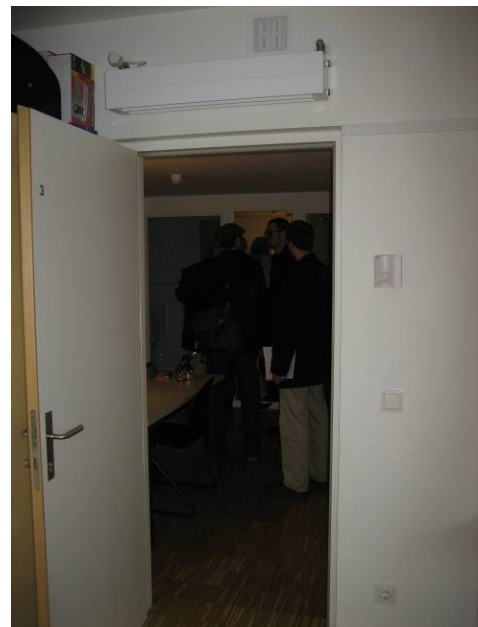
Abbildung 7: Heizkörper und Zuluftauslass. Foto: R.Smutny
