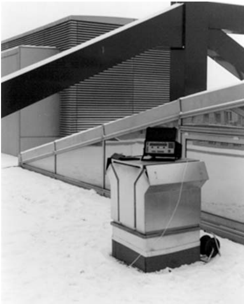
Abb. 3: Untersuchung des Geruchstransfers über Dach, im Vordergrund Auslass Entlüftung Kochstellen Mensa, im Hintergrund Frischlufteinlass Mensa/Hörsäle
