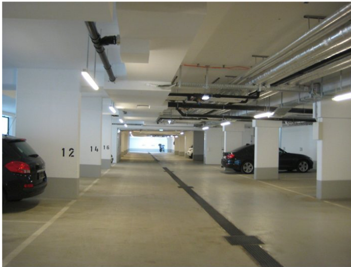
Abbildung 27: Umsetzungsbeispiel für hellen Bodenbelag in einer Tiefgarage
