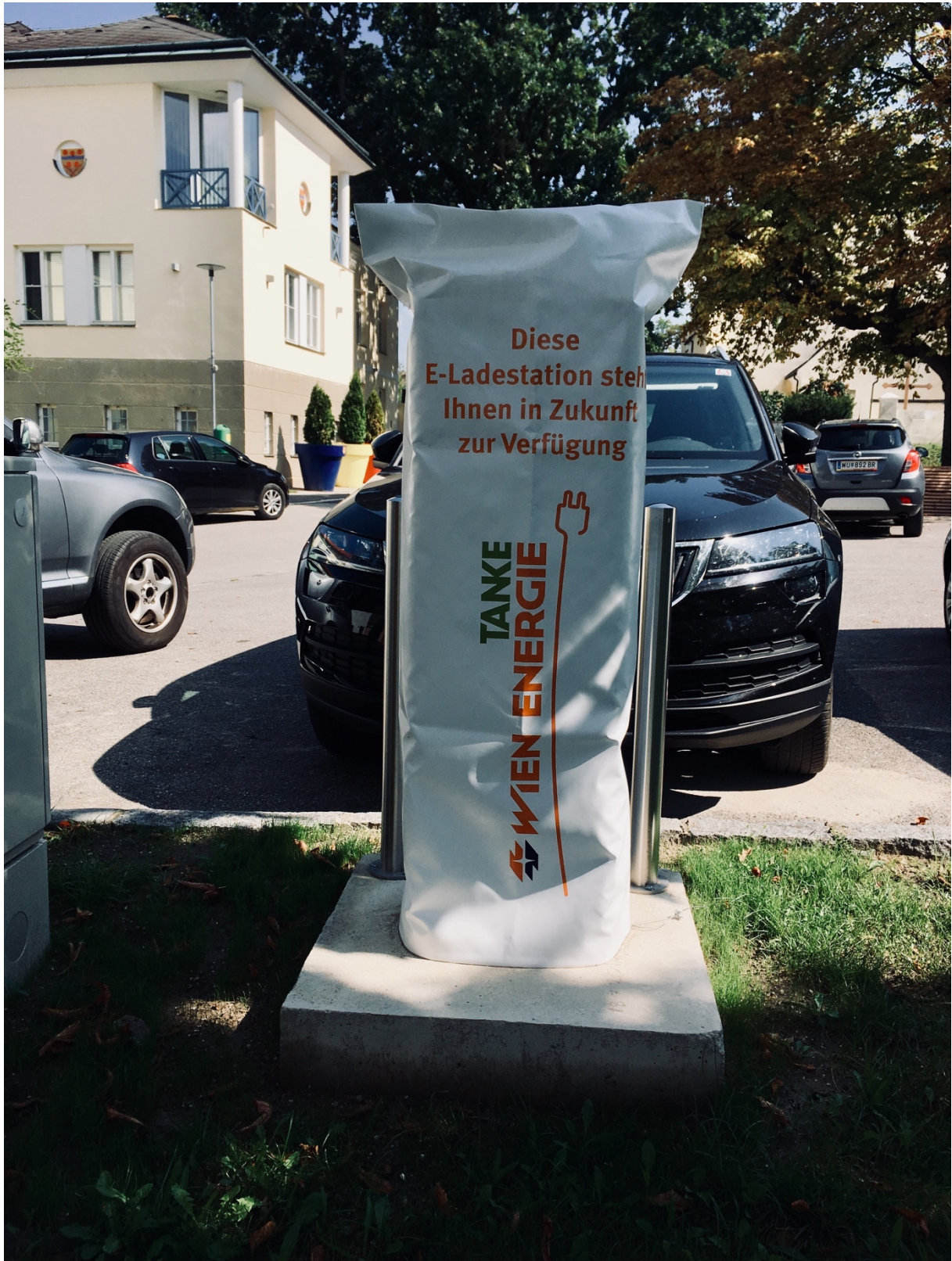
Abb. 10 Künftige Stromtankstelle der Wien Energie in Gerasdorf | Foto Peter Görgl
