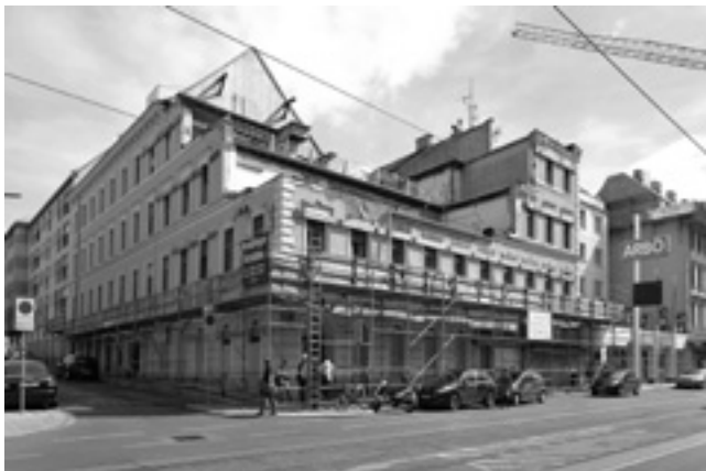
15., Mariahilfer Straße 182: So sah die Fassade des Wohnbaus nach der Explosion aus.
