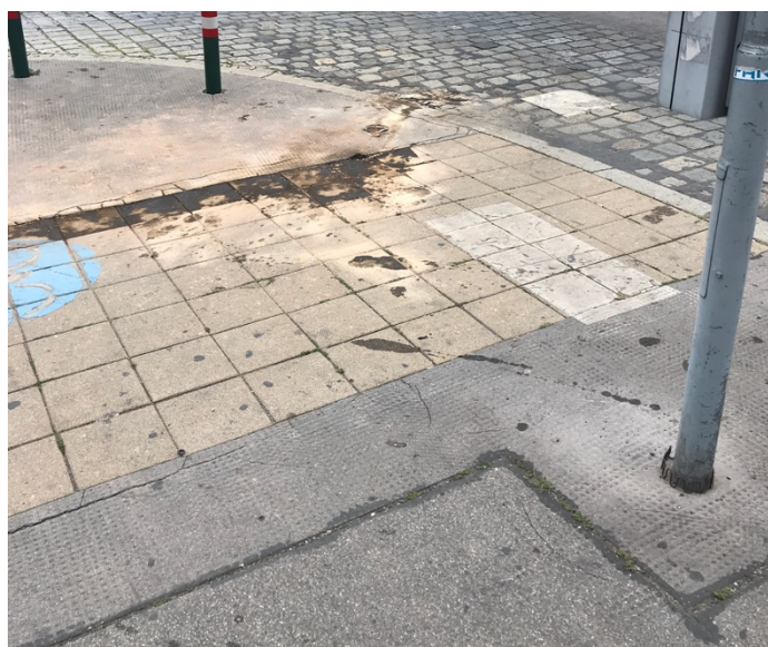
Abbildung 13: Aufgebrochener Asphalt, lose Betonplatten und Pflastersteine (Foto: Höfner)
