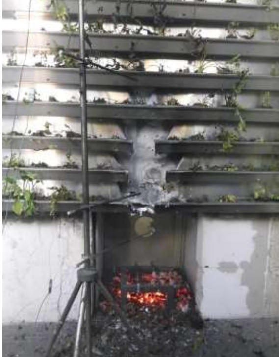
Abbildung 4-38: Fassadenbegrünung nach der Prüfung
