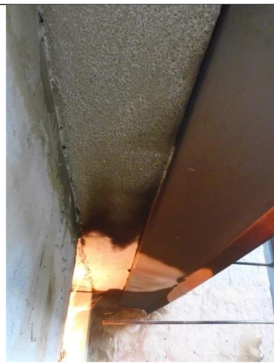
Abbildung 4-28: Dunkelfärbung des Oberputzes des WDVS im Sturzbereich, Putzschicht intakt
